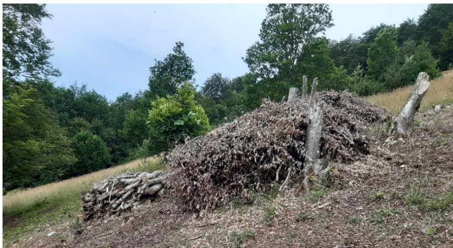
Bei Entbuschungsarbeiten auf der Pâturage du Droit de Vauffelin wurde das Material auf Haufen geschichtet und so neue Strukturen geschaffen
